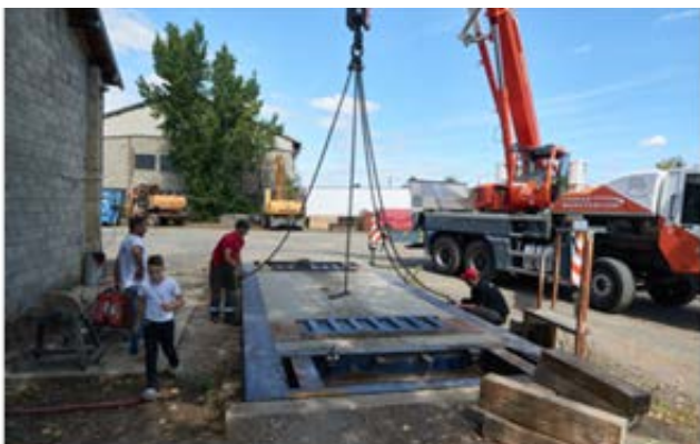
Pont bascule pour la pesée des camions
