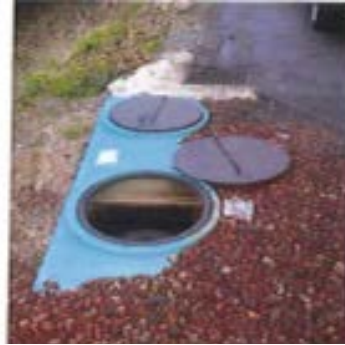
Regard d'un bac débouilleur-déshuileur
